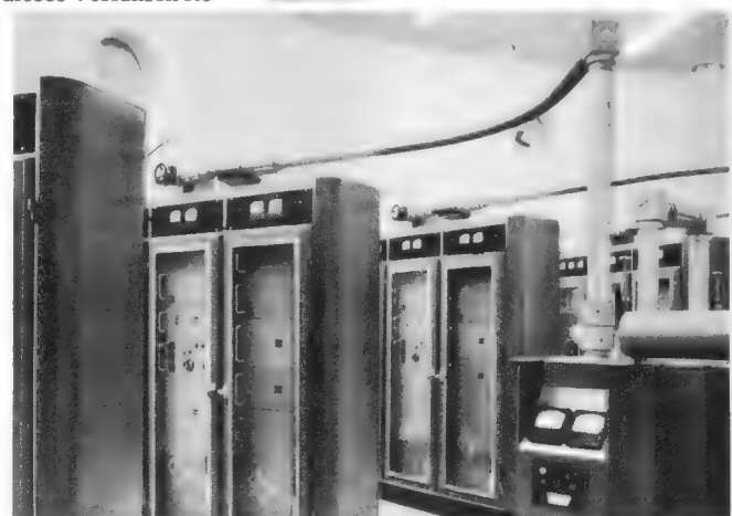
Bild 2. Im Fuß des Johannesburger UKW-Turmes sind sechs 10-kW-UKW-Rundfunksender aufgestellt. Im Bild sind Teile der Senderschränke und der Antennenweiche erkennbar
